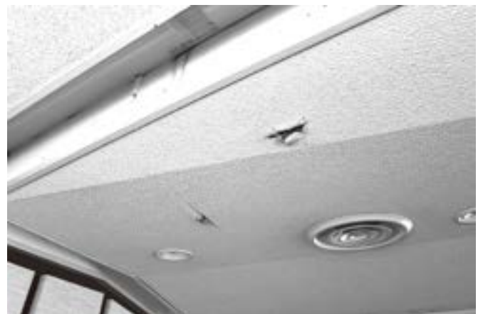
議場天井の雨漏り箇所
